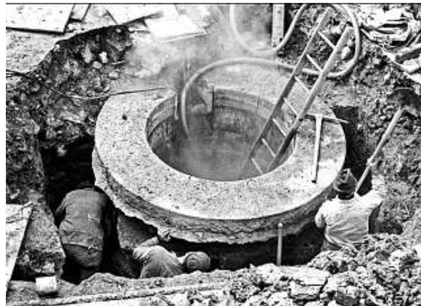
Letzte Öffnung des grossen Steins und Sanierung des Quellschachts 1967/68, Quellenkranz stammt aus dem Jahr 1944
